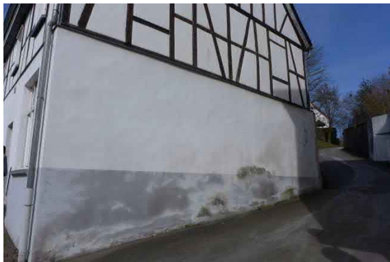
Abbildung 44: Bauliche Mängel an Gebäuden der Altstadt
